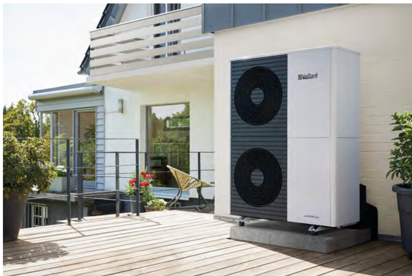
Vaillant: moderne Technik rund ums Heim
